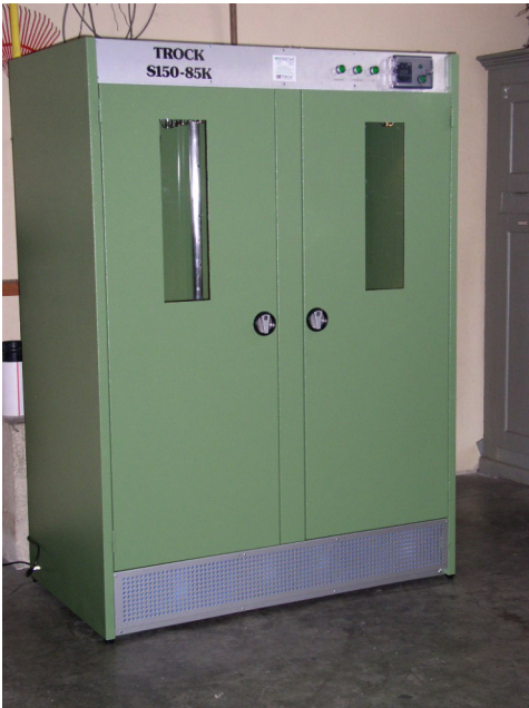
S150-85K : centrale électrique Zürich, Sils im Domleschg
