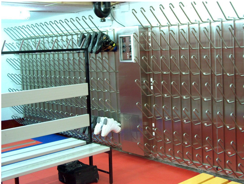
Spezialanlage für 165 Paar, Centralsport AG, Wengen
