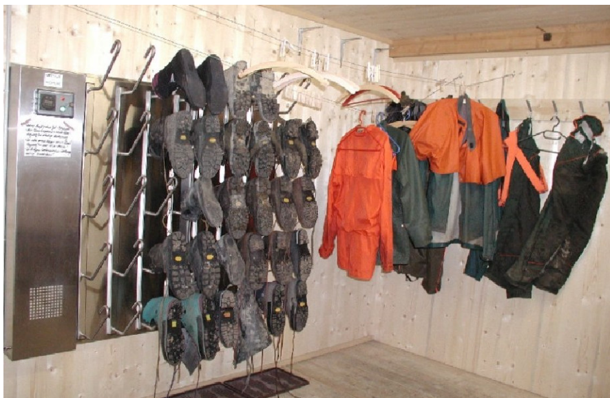
T1020, im Trocknungsraum bei der Forstverwaltung Interlaken Die Arbeitskleider trocknen durch die Warmluftumwälzung des Schuhtrocknungssystems gleichzeitig mit!
